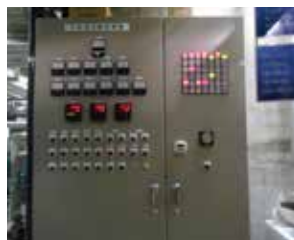
水処理制御装置
